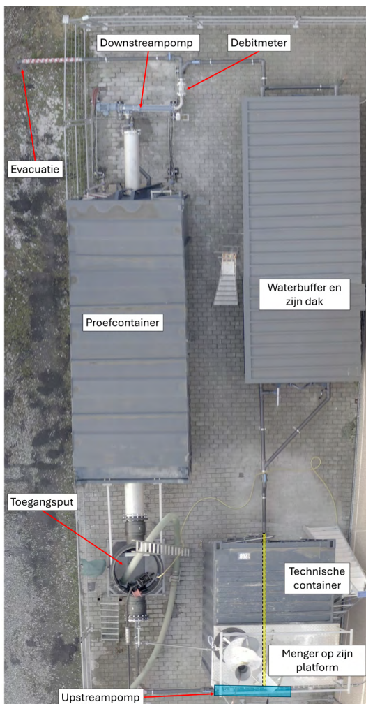
Figuur 1 – Geannoteerde luchtfoto van de testopstelling, geïnstalleerd langs het gebouw van OCW in Wavre.
