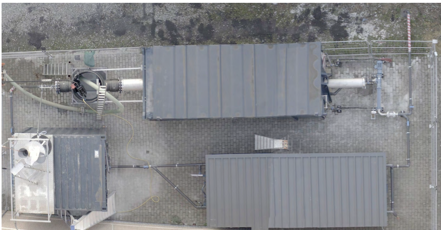
Figuur 1 – Luchtfoto van de testopstelling, geïnstalleerd langs het gebouw van OCW in Waver
