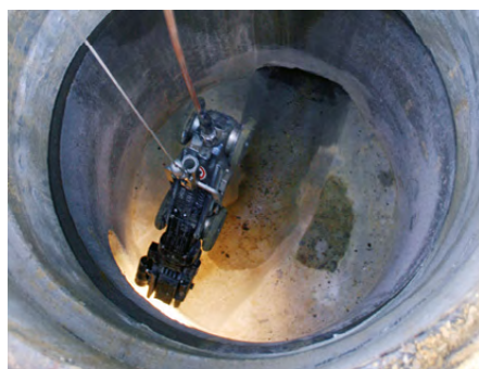
Gestion des réseaux d'égouttage
