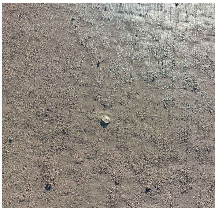
Figure 8 – Cratère de ressuage apparaissant à la surface du revêtement, principalement lorsqu'une vitesse rapide est utilisée
