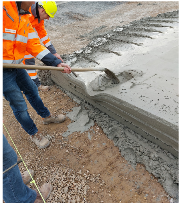
Figure 10 – Accumulation de pâte de ciment à la surface dans la zone finale de la section
