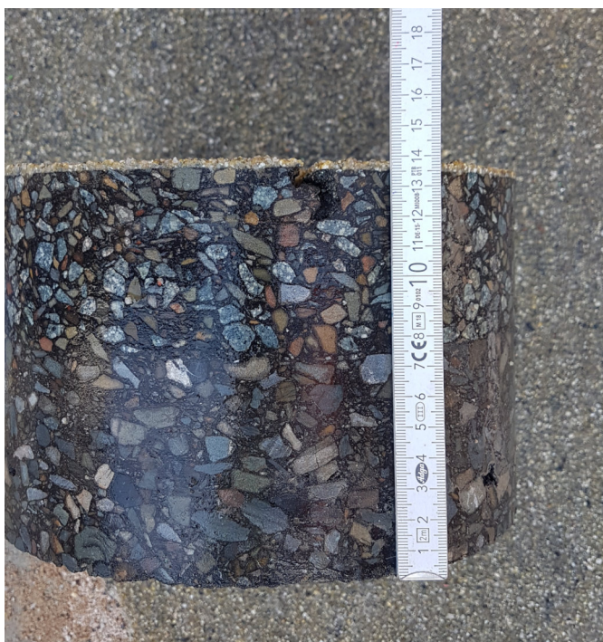
Figuur 3 - Dwarse scheurvorming in epoxycoating, kernboring en scheur in toplaag (voorbeeld C)
