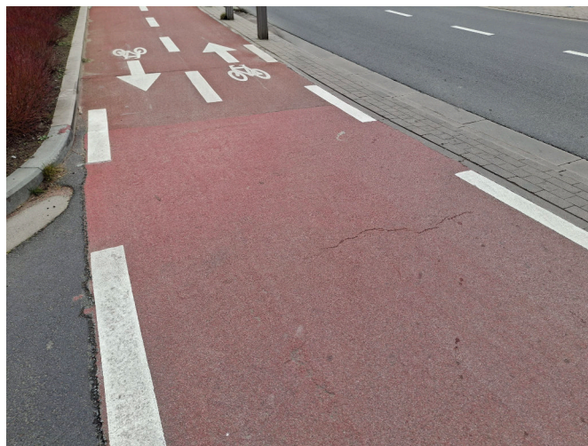
Figuur 2 - Dwarse en langse scheurvorming in epoxycoating (voorbeeld B)
