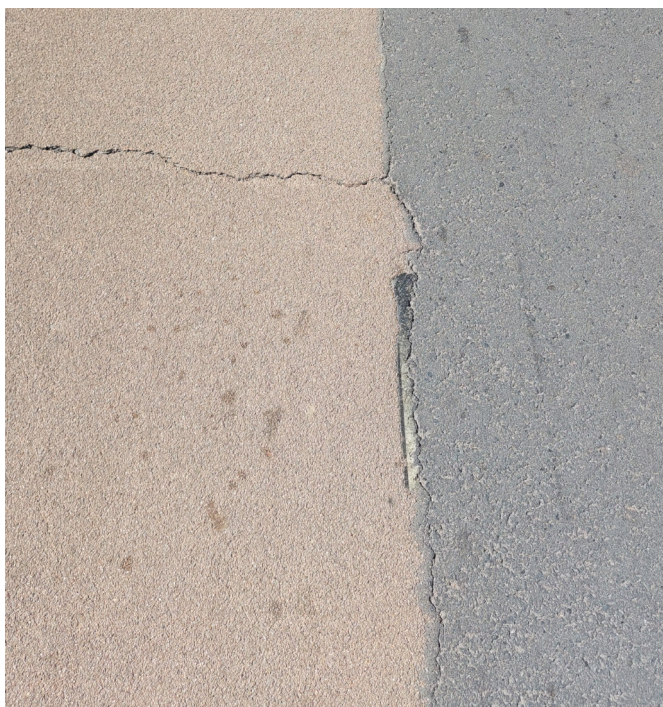
Figuur 6 - Langse scheur in combinatie met dwarse scheur langs rand epoxyzone (voorbeeld C)
