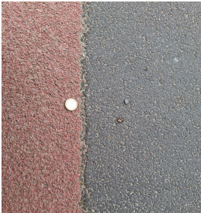
Figuur 4 - Langse scheur langs rand epoxyzone (voorbeeld A)
