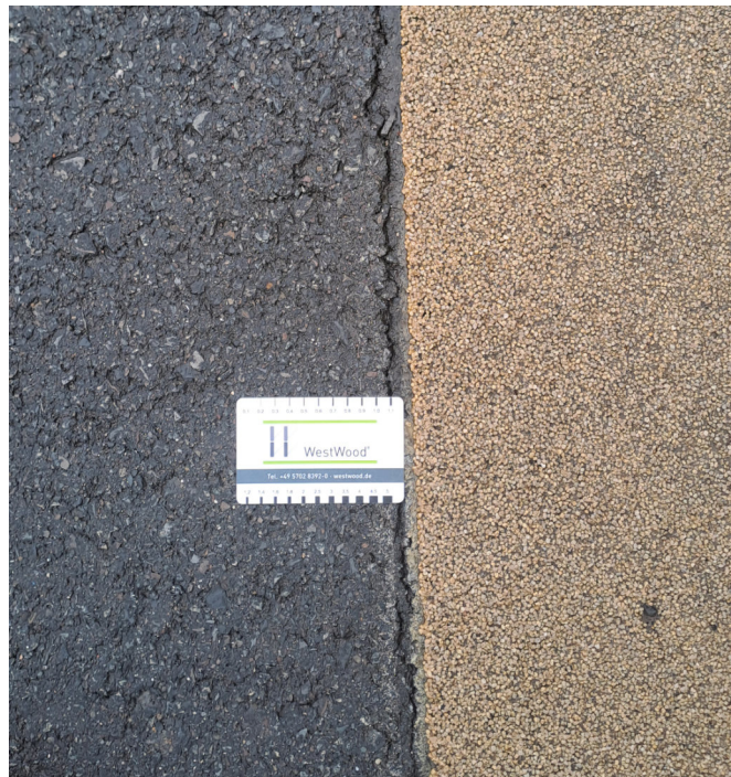
Figuur 5 - Langse scheur langs rand epoxyzone (voorbeeld B)
