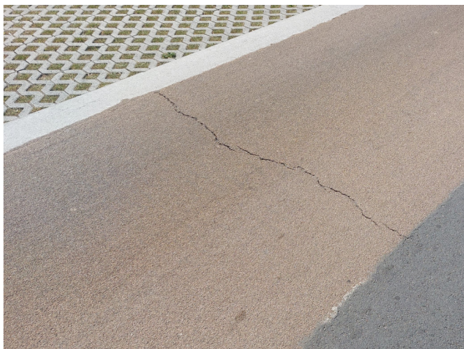
Figuur 1 - Dwarse scheurvorming in epoxycoating (voorbeeld A)
