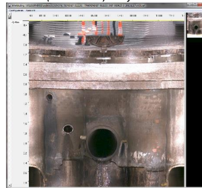
Foto 60 (Bron BRRC) Schadebeeld rioolput
