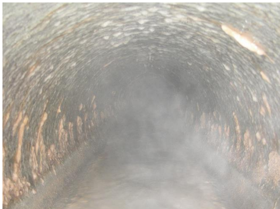
Foto 13 (Bron BRRC) Beperkt zicht door waterdamp
