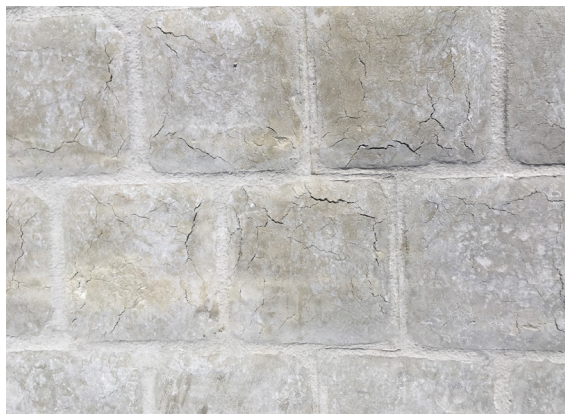
Figure 6.2 – Microfissures dans du béton imprimé, probablement en raison d'un mélange de béton trop sec (©Febelcem).
