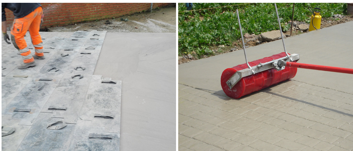
Figure 4.5 – Impression à l'aide de moules en plastique (à gauche, ©Colas Belgium) ou à l'aide d'un rouleau texturé (à droite, ©Febelcem)
