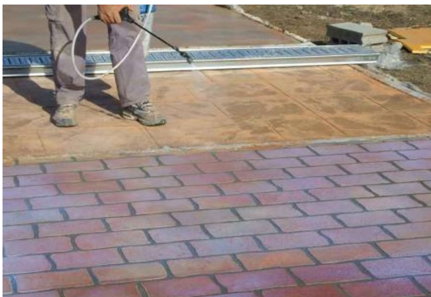
Figure 4.12 – Protection contre l'écaillage par application bouche-pores (« sealer ») à base de résine acrylique (©Febelcem)
