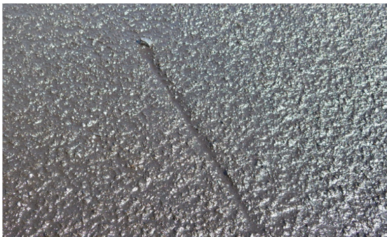
Figuur 2.20 – Langsgroef – ook de oorzaak (grove steen) is duidelijk nog zichtbaar
