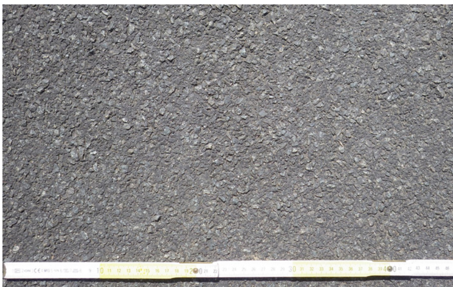
Figuur 2.10 – Ernstgraad 0 scholvorming – geen schollen aanwezig
