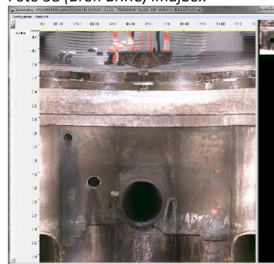
Foto 60 (Bron BRRC) Schadebeeld rioolput
