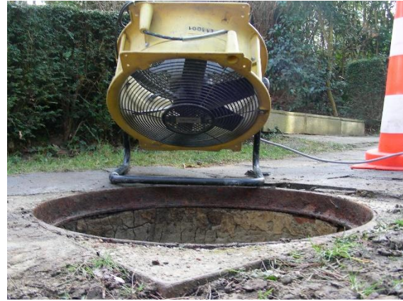
Foto 14 (Bron BRRC) Geforceerde ventilatie
