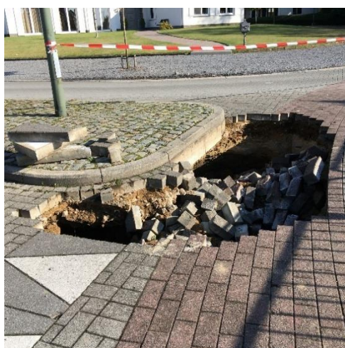
Foto 1 (Bron BRRC) Ernstige schade door een ingestorte rioolleiding
