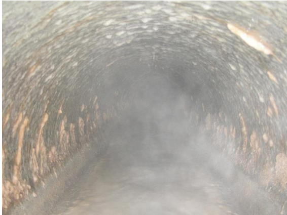
Foto 13 (Bron BRRC) Beperkt zicht door waterdamp
