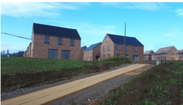
Figuur 4 – Bouwplaats met de uitvoering van een halfverharding in Waver (oktober 2020) ; (Grégoire et al., 2021, 2022)
