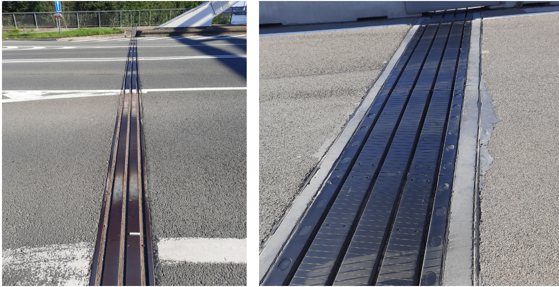
Figuur 3.8 – Meervoudige voegen met twee stalen lamellen (links) en drie rubberen lamellen (rechts)
