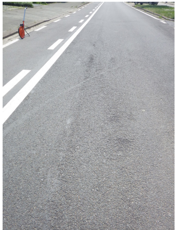
Figure 13 - Planche d'essais P à Wilrijk présentant un plumage important après un an
