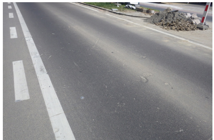
Figure 15 - Dommages causés par les travaux
