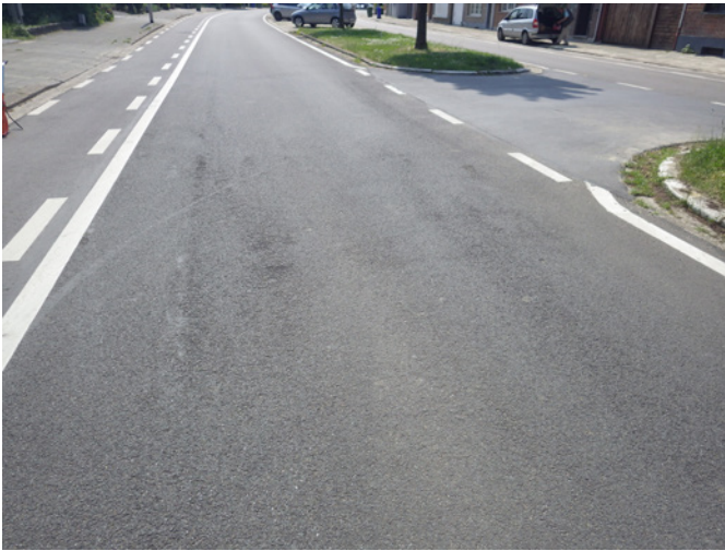
Figure 9 – Plumage important à l'endroit où l'enrobé était trop froid pendant la mise en œuvre
