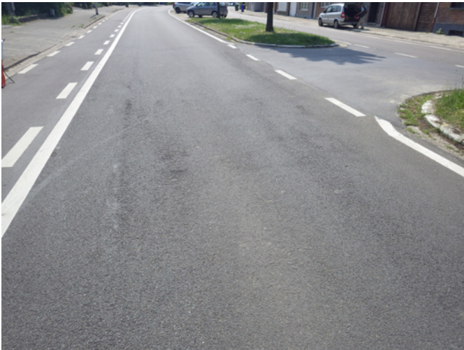
Figuur 9 – Ernstige rafeling op de plaats waar het asfalt te koud was tijdens de aanleg
