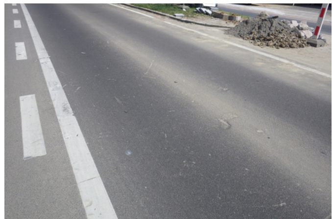
Figuur 15 - Schade door werken
