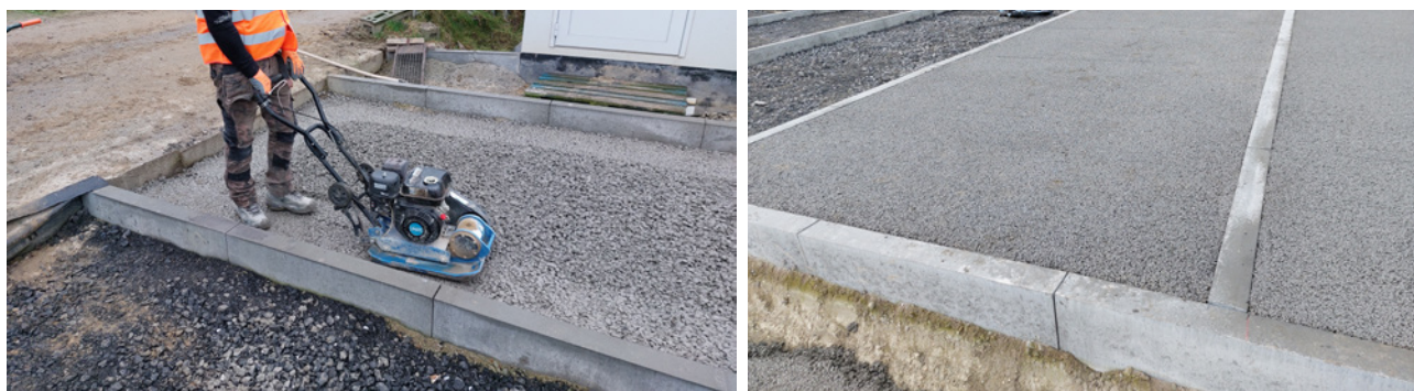
Figuur 1 – Recente toepassing van drainerende betonsamenstellingen op proefvakken in samenwerking met Aquafin en Holcim te Sint-Niklaas
