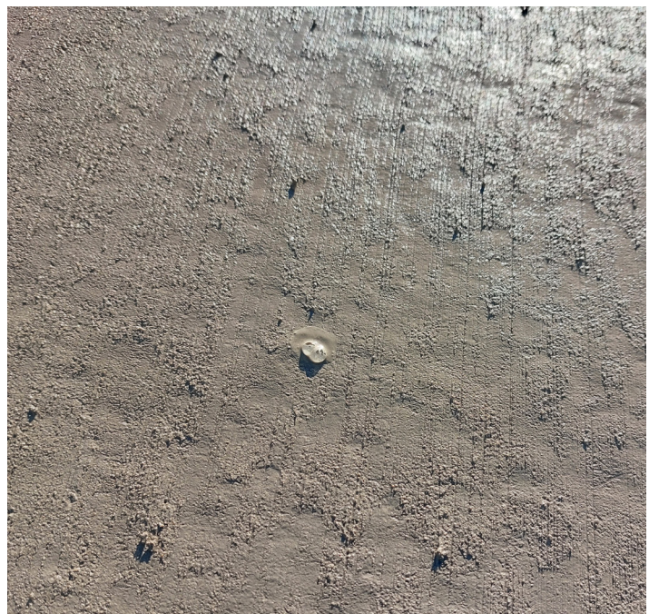
Figuur 8 - Krater door zweeten aan het oppervlak van de verharding, vooral wanneer een hoge snelheid wordt gebruikt
