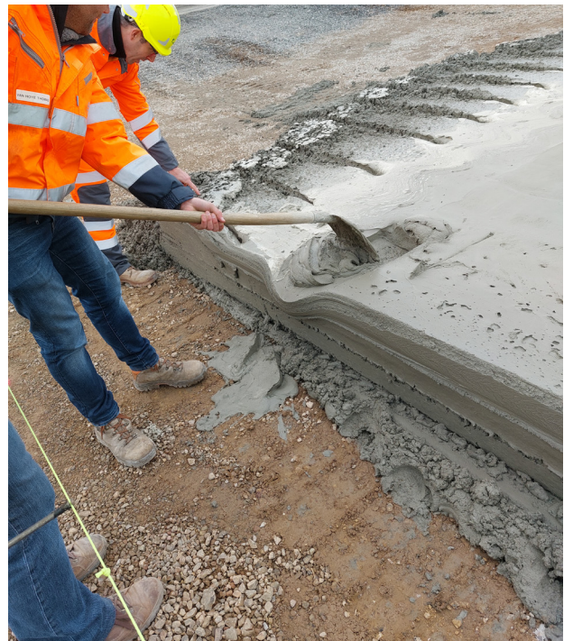
Figuur 10 – Ophoping van cementpasta aan het oppervlak in het laatste gedeelte van de sectie
