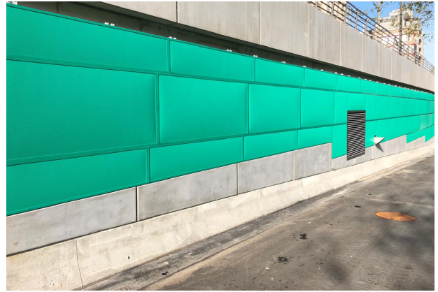
Revêtement absorbant pour parois de tunnels, Brabotunnel, Anvers
