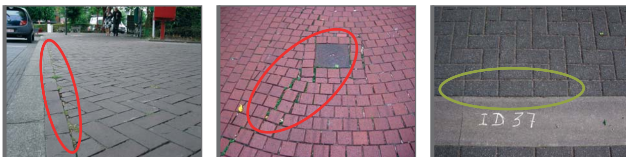
Figure 3.2 Finition des bords A gauche: finition des bords peu soignée avec pièces de réglage trop petites Au milieu: finition des bords peu soignée autour et aux abords d'un point singulier A droite: finition correcte avec une assise de panneresses en pavés
