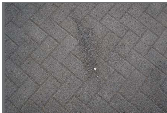
Figure 3.44 Exemple de matériau de jointoiment 0,5/2 pour un revêtement à pavés poreux en béton
