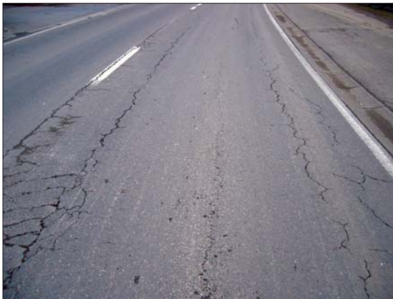
Fissures de fatigue
