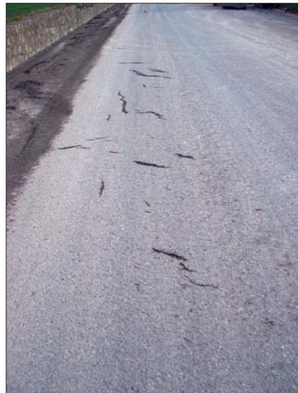
Fissures de glissement
