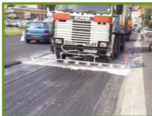
Figure 6 Application du lait de chaux comme protection contre les arrachements dus aux véhicules circulant sur le chantier
