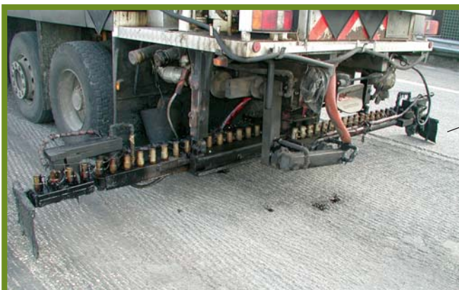
Figure 14 Répandeuse avec la mise en place de deux tôles à chaque extrémité de la rampe
