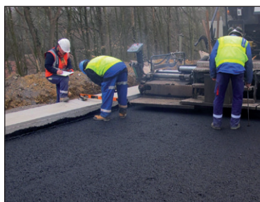
Figure 3.11 – Contrôles de niveau
