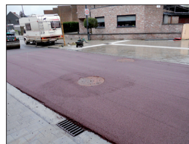
Figure 4.7 – Contamination après compactage
