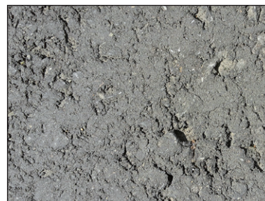
Figure 7.2 – Microfissuration d'un enrobé compacté à température trop basse
