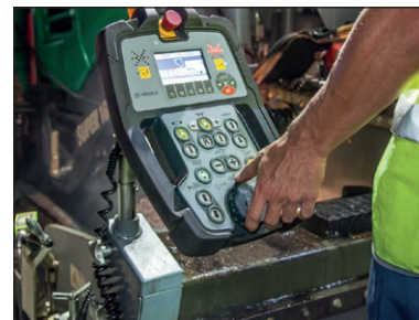
Figure 1.43 – Console de commande pour l'opérateur
