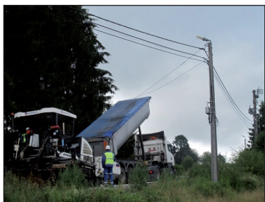
Figure 2.1 – Danger avec des câbles électriques
